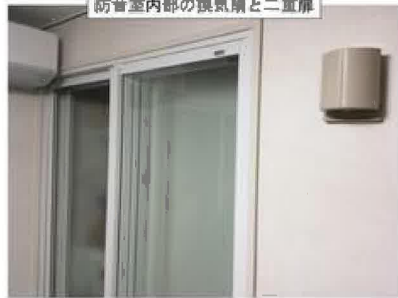
防音室内部の換気扇と二重扉
